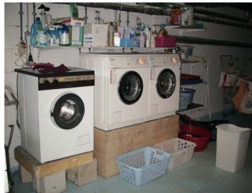
地下1階にある洗濯物乾燥器 熱源は屋上から引いた集熱パイプ
