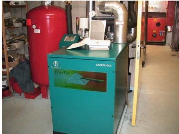
地下1階にある24時間換気のための空気送風機 背後の赤いタンクは熱湯の貯蔵タンク
