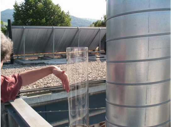
屋上まで伸びる換気と集熱の配管
