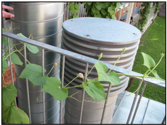
換気と集熱の配管
