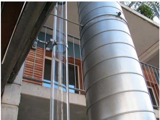
換気と集熱の配管
