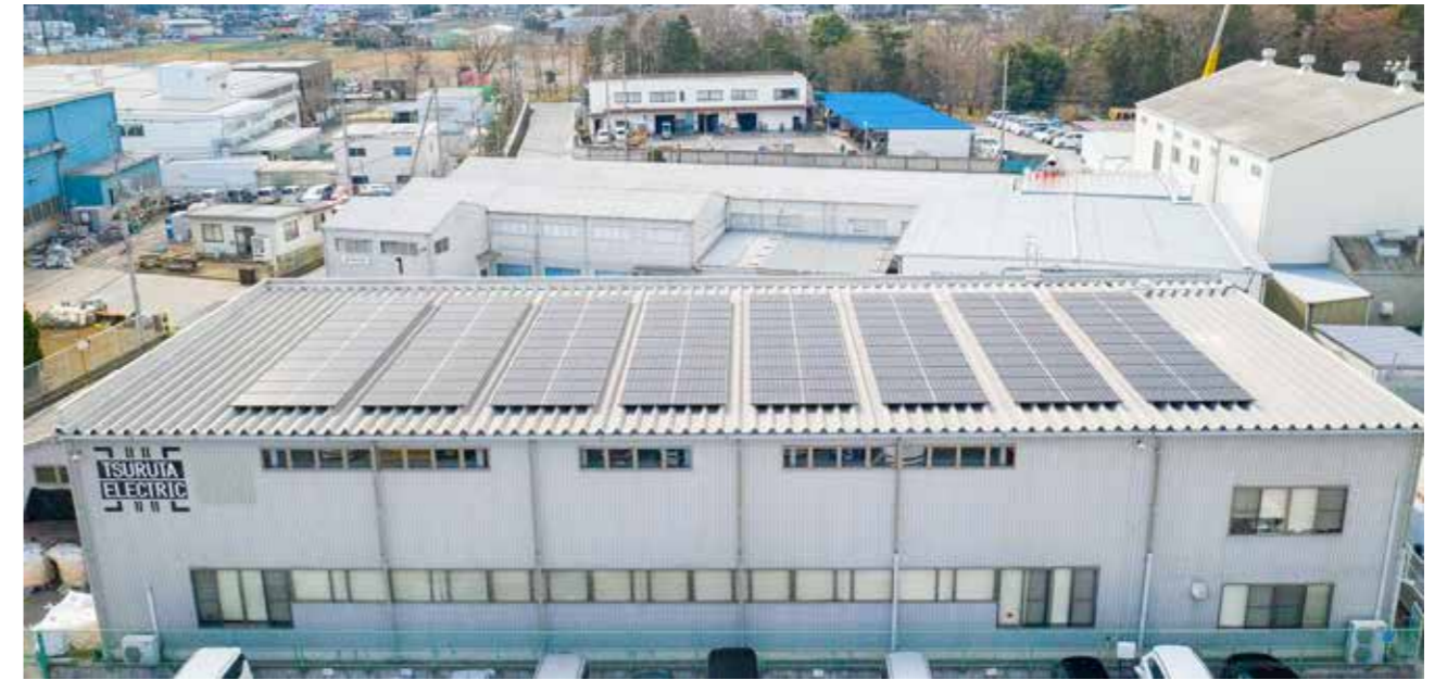
49.5kW ソーラーエッジ自家消費ソリューション SE25K-JP x2台 ソーラーエッジスマートモジュールSPV-300MMJ x176枚
